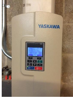
Garage fan VFD
